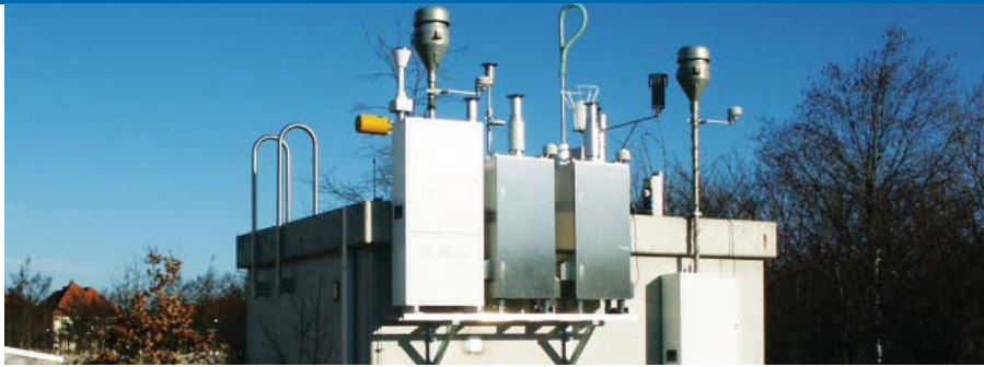
Messstationen zur Ermittlung der Feinstaubimmissionsbelastung in Augsburg
