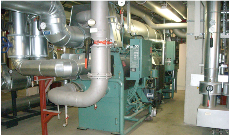
Abbildung 4-3: LiBr-Absorptionskältemaschine bei der Fa. Sachs in Schweinfurt, die mit Wärme des Gemeinschaftskraftwerks betrieben wird 1
